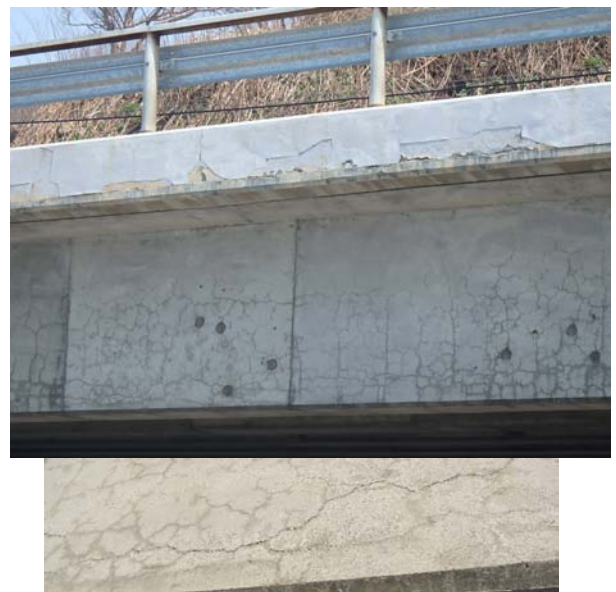
写真-1 損傷状況（海側外桁、最大ひび割れ幅 0.7 mm）
