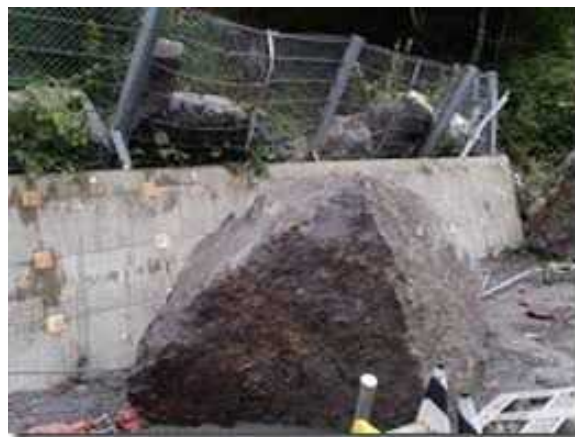
図-2 巨石、落石による破損例
