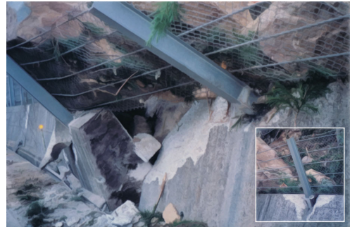
写真-1 支柱基部の損傷例 3)
