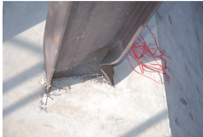
(b) PB 試験体の基部の変形状況
