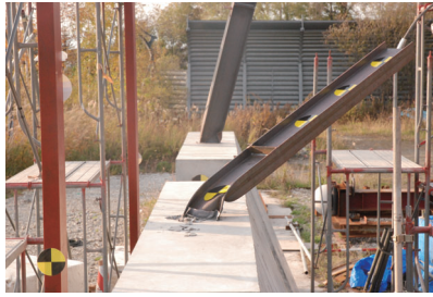
(a) 気中部における支柱の変形状況
