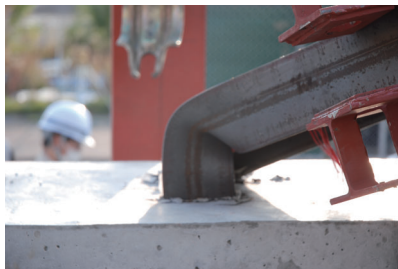
(d) PS 試験体の基部の変形状況-2
